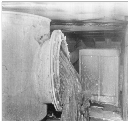
Temperatura atinsă în timpul incendiului a fost atât de mare încât componentele sistemului s-au topit
