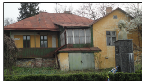
Cernăuți azi: Casa Aron Pumnul, după 100 ani (imagine datată: 10.04.2014; 6:53 p.m.) – se remarcă adăugirile degradante aduse imobilului
